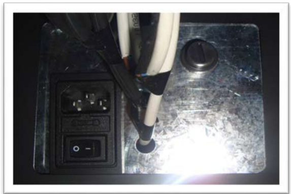
71. attēls. (drošības termostats un slēdža spraudnis)
